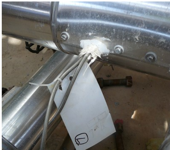
Figura 4.11.11. Ejemplo de salida de cable por el recubrimiento en instalación traceada.
