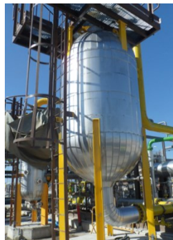
Figura 4.4.3.A Ejemplo aislamiento en equipo vertical.
