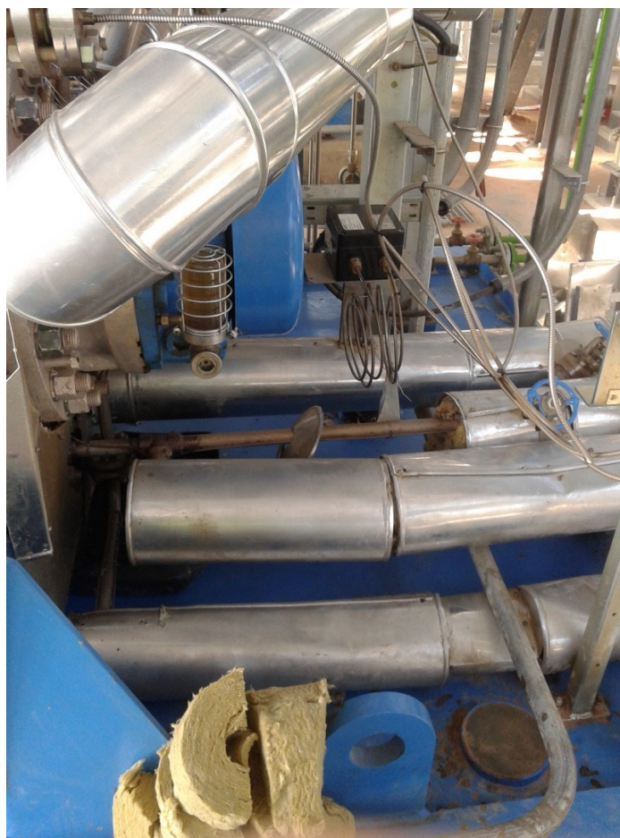
Figura 4.12.2. B Ejemplo de aislamiento dañado en planta.
