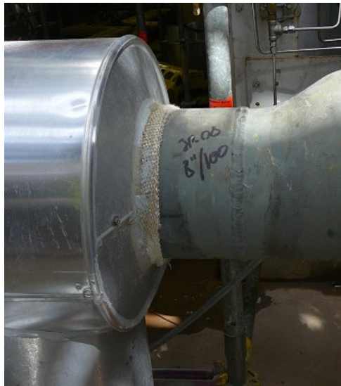
Figura 4.11.10. Ejemplo de ejecución de rotura de puente térmico entre tapa de recubrimiento metálico y tubería para más de 250 °C.
